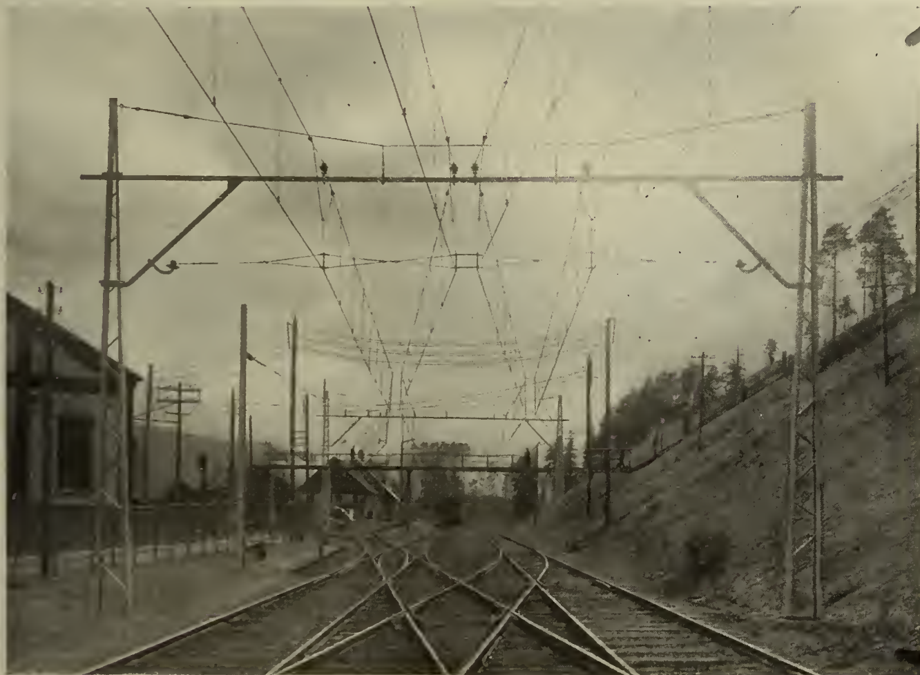
Fig. 125. — Vue de la ligne de prise de courant.
