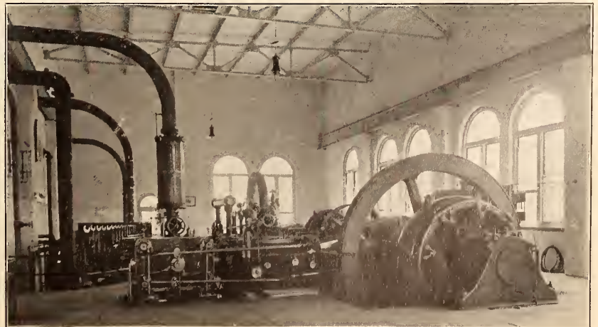
FIG. 8—VIEW IN ENGINE ROOM, 200 K. W. GENERATOR—C. & E. I. R. R.
