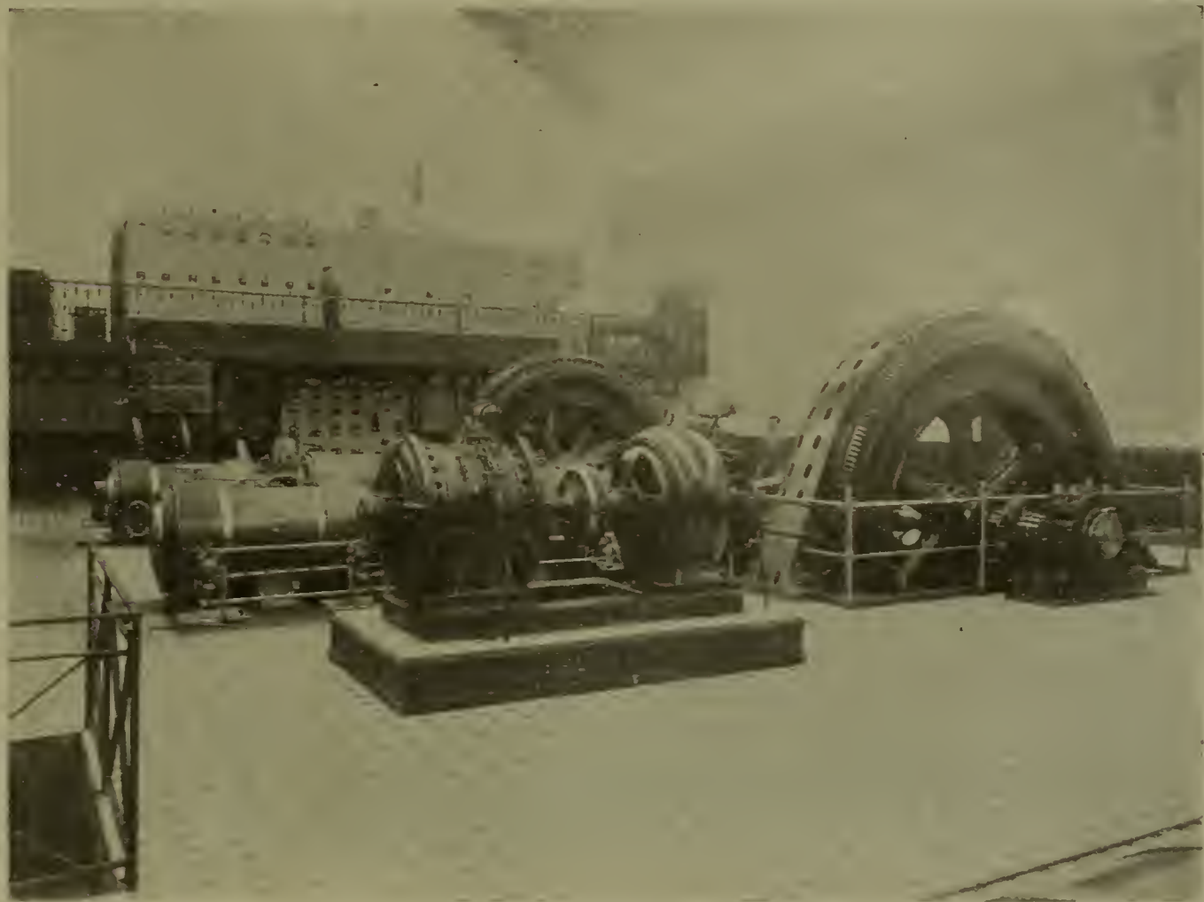
Fig. 174. — Usine génératrice d'une mine.
