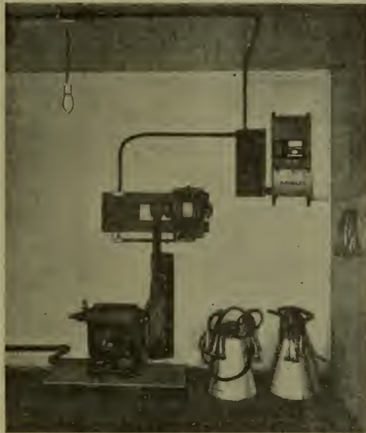
Fig. 155. — Installation électrique pour la traite mécanique par le vide.
