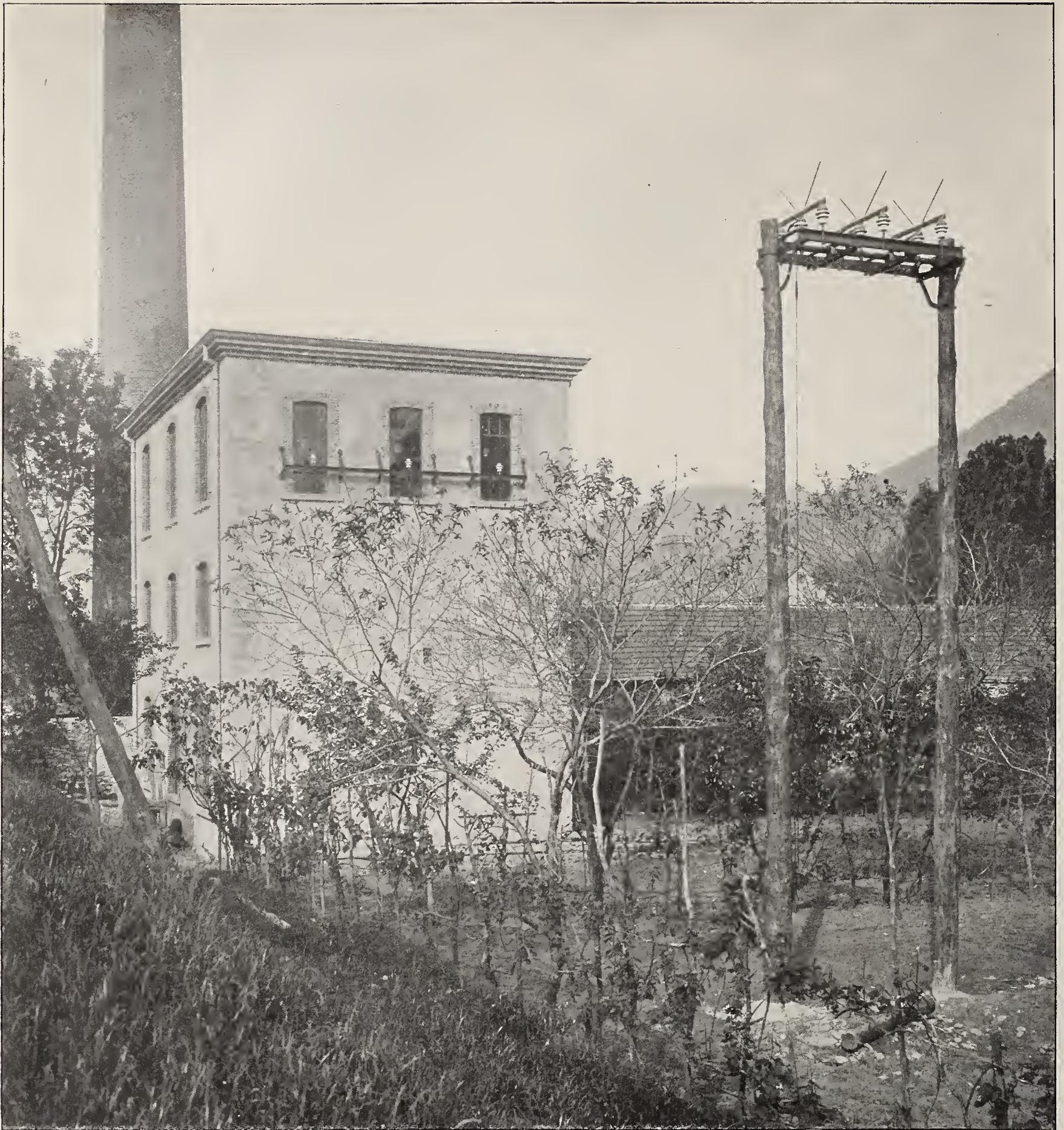
THE SUB-STATION AT NEMBRO
